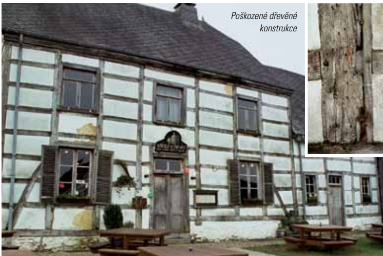
Deformované klenuté dřevěné rámy a oslabené vazné trámy
