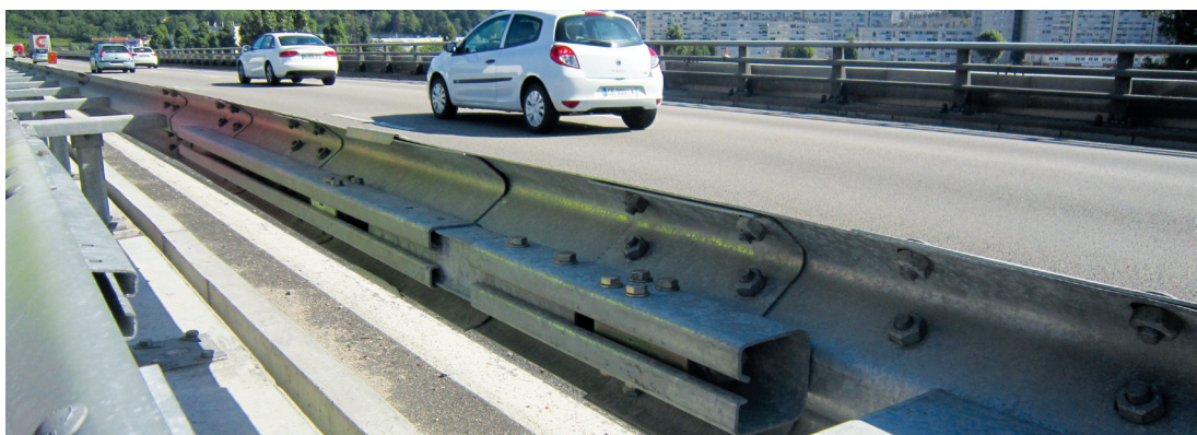
Svodidlo vybavené dvěma Transpec 4-18
